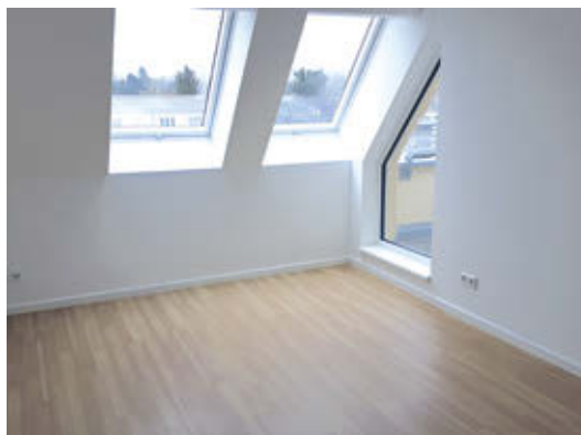
Dachgeschoss 3-Zimmer Wohn-Essbereich
